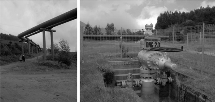
Gambar 12. Pipa-Pipa Gas Panas Bumi yang Dikelola PT. Geo DIPA Energi
