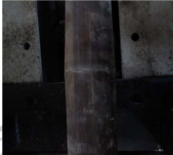
Gambar 5.1. Kerusakan Yang Terjadi Pada Bambu Isian Mortar
