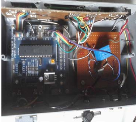
Blok mikrokontroler dan relay
