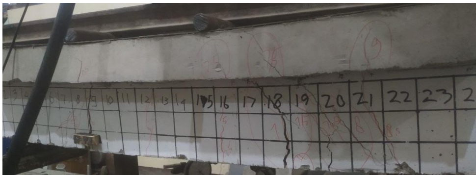
Gambar 4. 19. Pola Retak Balok Perkuatan
