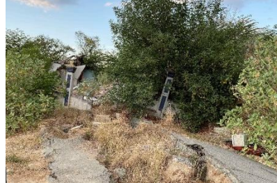
Foto 3'. Setelah gempa (dilihat dari Utara)
