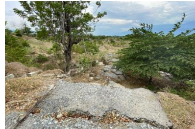
Foto 4'. Setelah gempa (dilihat dari Barat Daya)
