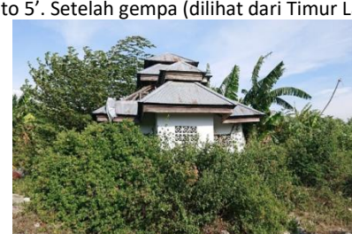
Foto 6'. Setelah gempa (dilihat dari Timur)
