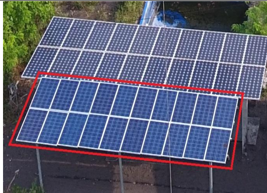
Gambar 4. 7. Panel Surya sistem 48 V / 2 kW (Sumber: Dok. Pribadi)
