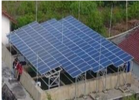
Gambar 4. 4. Panel Surya sistem 240 V / 15 kW (Sumber: Dok. PLTH)
