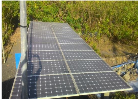
Gambar 4. 6. Panel Surya sistem 48 V / 2 kW (Sumber: Dok. PLTH)
