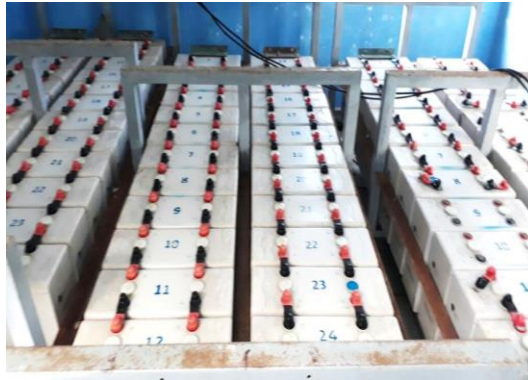
Gambar 4. 9. Baterai Penyimpanan KKP (Sumber: Dok. Pribadi)
