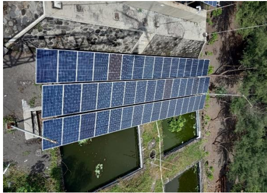
Gambar 4. 5. Panel Surya sistem 48 V / 10 kW (Sumber: Dok. PLTH)
