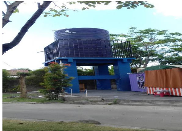
Tandon Penampungan Air
