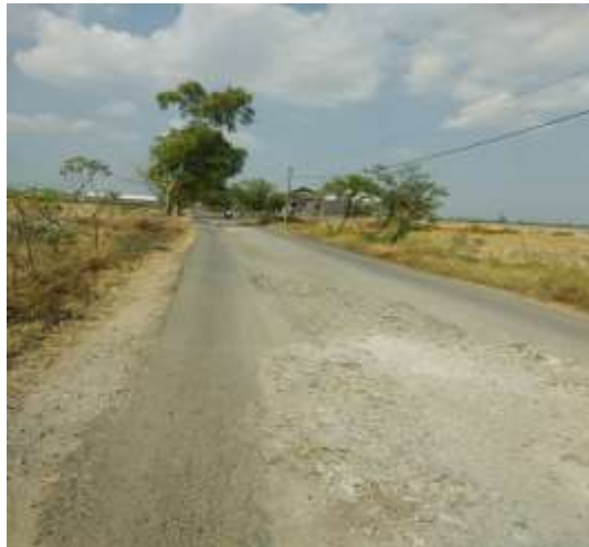
Gambar 4.7. Kondisi jalan di Desa Sumber : Dokumentasi Penelitian Tahun 2019
