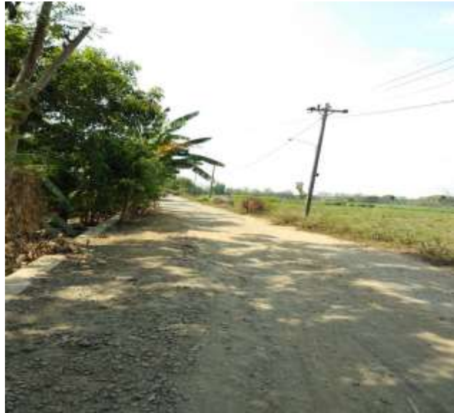
Gambar 4.4 Kondisi jalan di Desa Sumber : Dokumentasi Penelitian Tahun 2019
