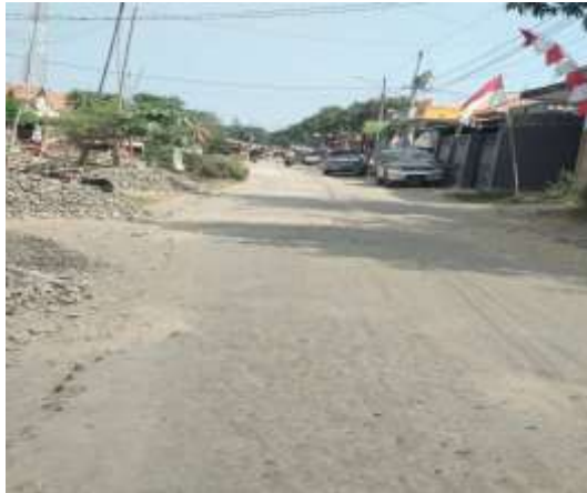
Gambar 4.8. Kondisi Jalan di Desa Sumber : Dokumentasi Penelitian Tahun 2019
