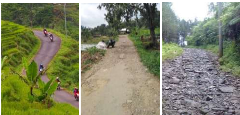
Gambar 4.6. Kondisi jalan utama (kanan), Kondisi jalan desa rusak sedang (tengah), dan Kondisi jalan desa belum diaspal (kiri)
