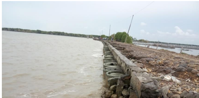
Gambar 4.19 Dinding pantai yang terbuat dari pipa beton di Dukuh Pandansari Desa Bedono
