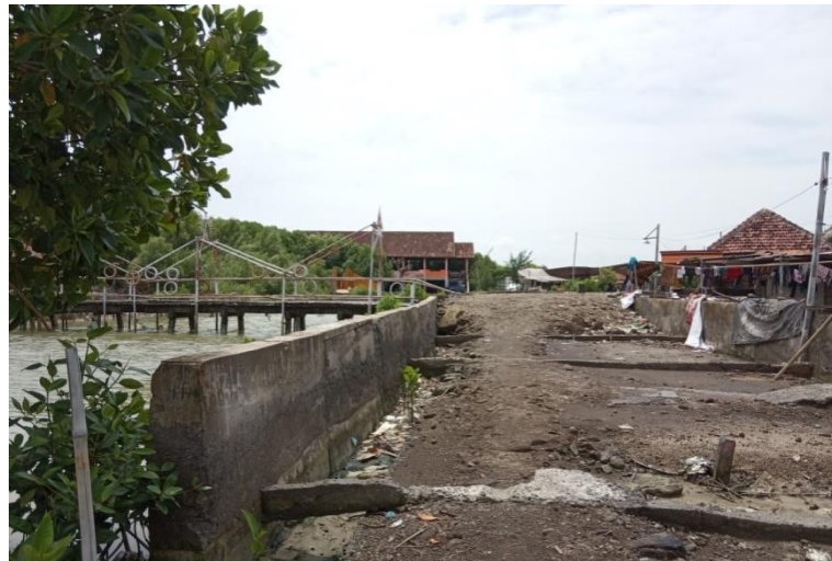
Gambar 4.45 Adaptasi akomodasi secara fisik untuk sungai dengan cara membuat dinding sungai di Dukuh Bedono Desa Bedono Sumber: Dokumentasi Lapangan, 2020
