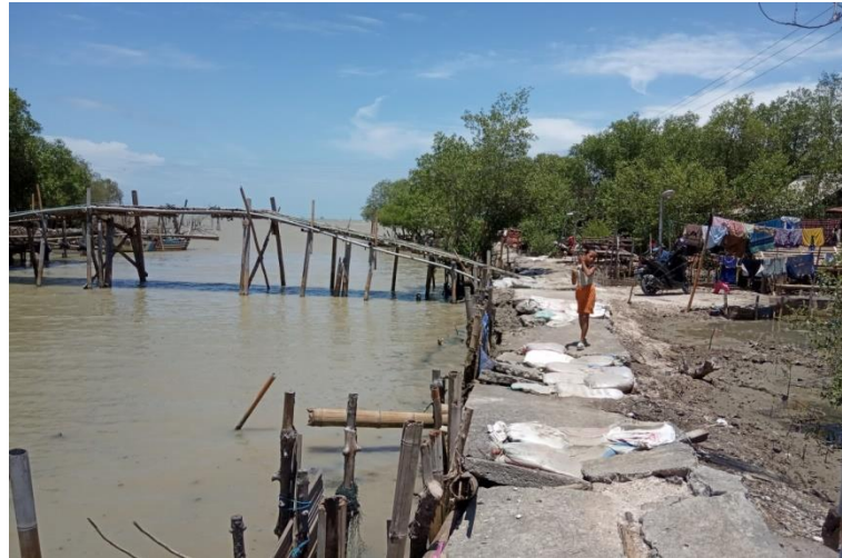
Gambar 4.48 Adaptasi akomodasi secara fisik untuk jalan lokal yang rusak dengan cara menutupi retakan-retakan jalan menggunakan karung yang berisi krikil di Dukuh Bedono Desa Bedono Sumber: Dokumentasi Lapangan, 2020
