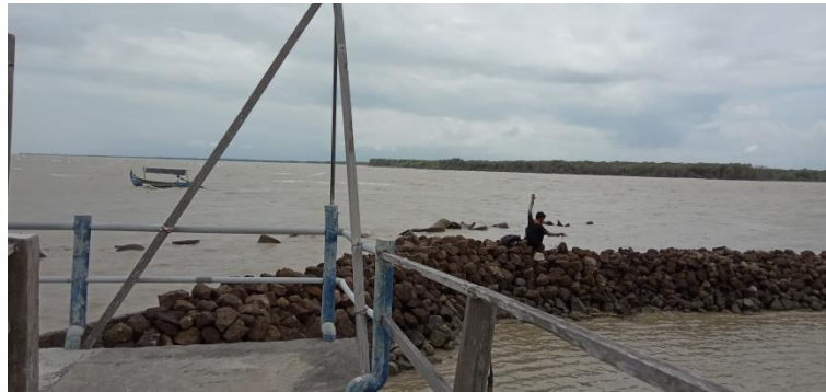
Gambar 4.24 Pemecah gelombang terbuat dari tumpukan batu dengan seri bangunan di Dukuh Tambaksari Desa Bedono Sumber: Dokumentasi Lapangan, 2020
