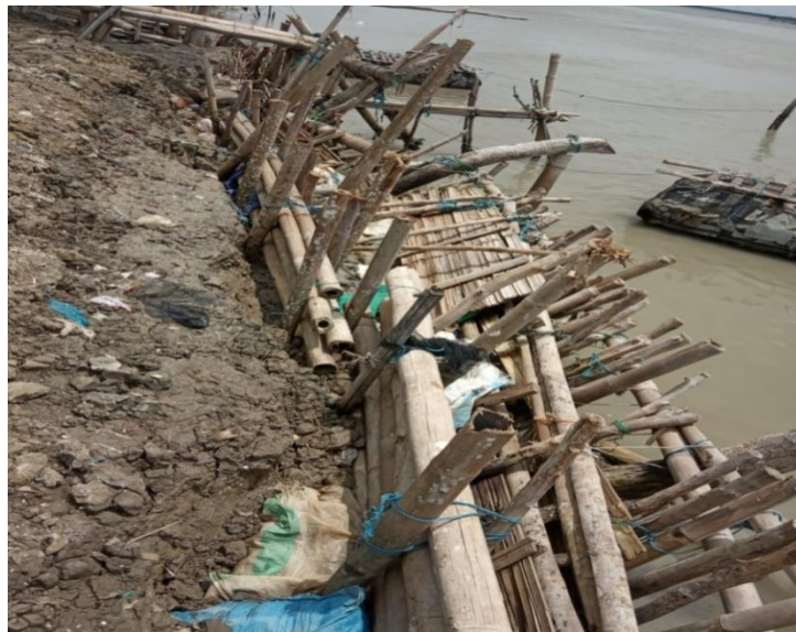
Gambar 4.21 Dinding pantai yang terbuat dari tumpukan kayu di Dukuh Bedono Desa Bedono
