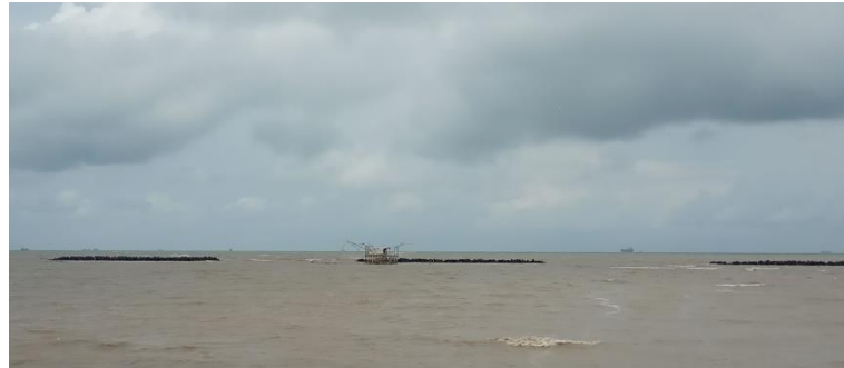
Gambar 4.22 Pemecah gelombang terbuat dari blok-blok beton dengan seri bangunan yang terlihat di Dukuh Tambaksari Desa Bedono Sumber: Dokumentasi Lapangan, 2020
