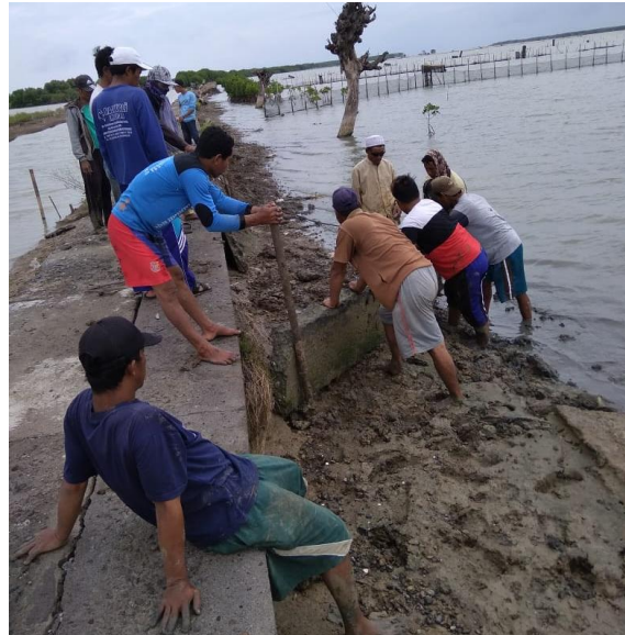
Gambar 4.54 Warga Dukuh Mondoliko gotong royong memperbaiki jalan di Desa Bedono Sumber: Dokumentasi Lapangan, 2020
