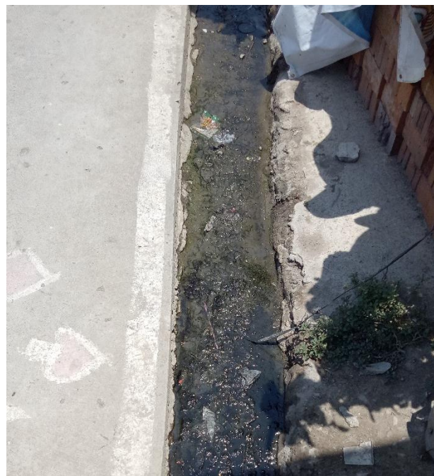
Dokumentasi kondisi selokan
