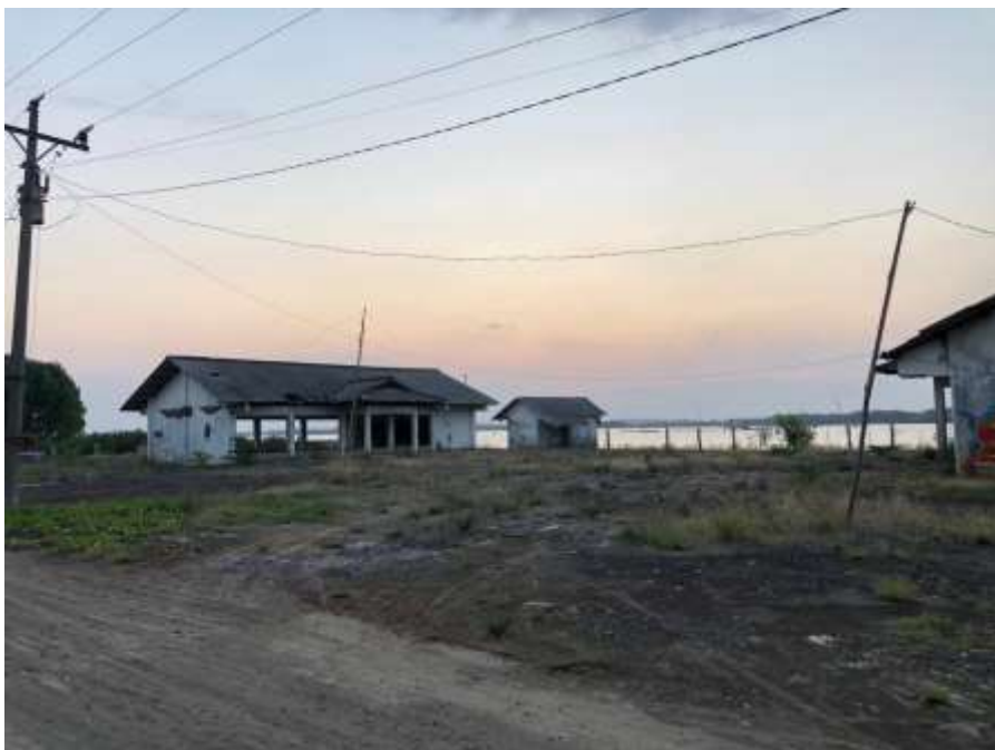
Gambar kondisi Tempat Pelelangan Ikan (TPI) yang rusak dan tidak terpakai
