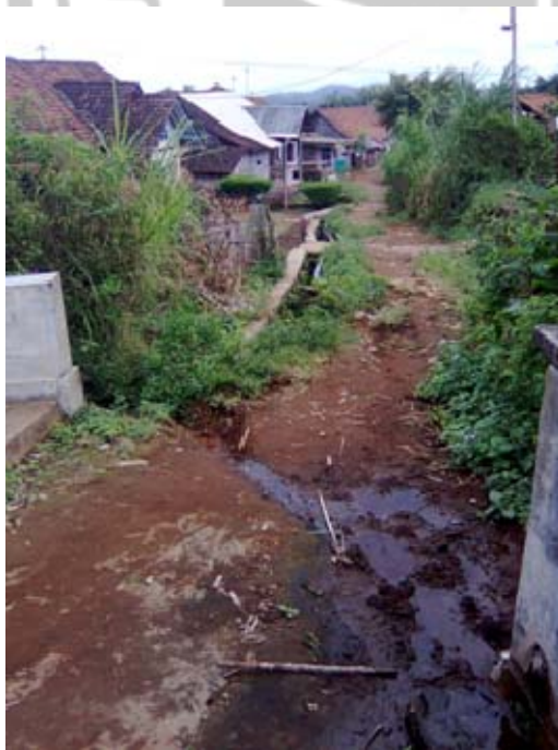
Gambar 2. Pipa-pipa yang disalurkan ke tempat warga berada di atas selokan dan tidak terlindungi
