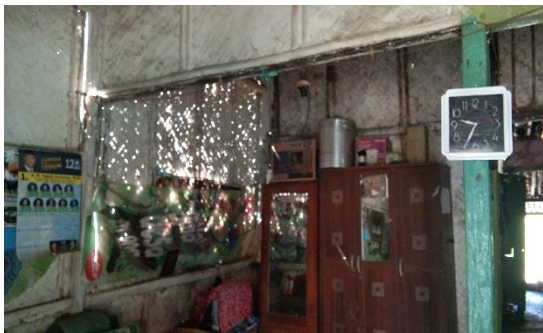
Kondisi rumah responden kasus tanpa ventilasi rumah
