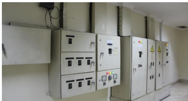
Gambar 2.98 Ruang ME JCC Sumber : Dokumentasi Pribadi
