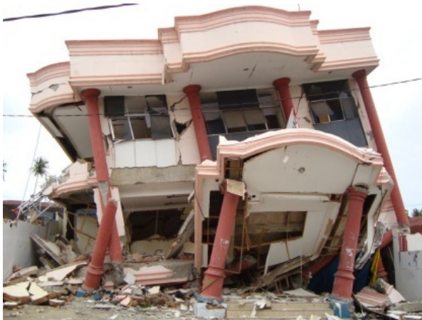
Gambar 22. Kerusakan bangunan akibat gempa di Padang Sumber: Tribunews.com. 2011
