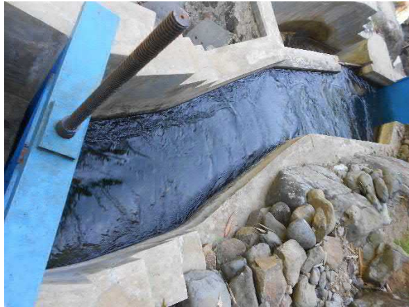
Gambar 2.5 Bak Pengendap / Bak Penenag (Sumber: Dokumentasi PLTMH Sokokembang)
