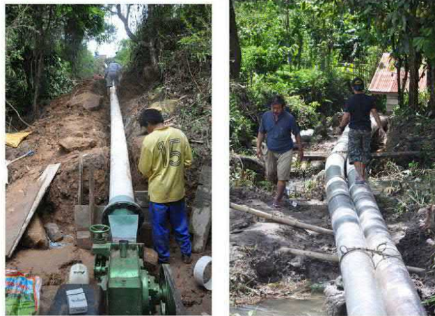
Gambar 2.6 Pipa Pesat (Penstock) (Sumber : Hunggul Y.S.H. Nugroho dan M. Kudeng Sallata., 17)
