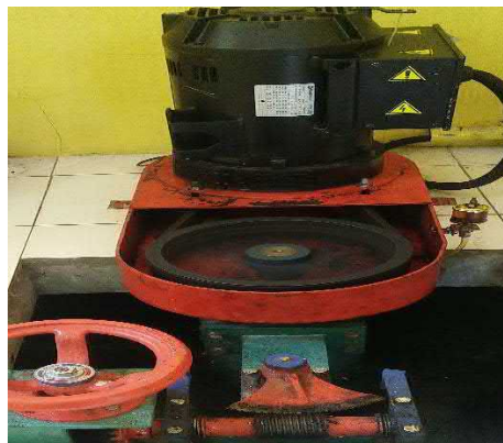
Gambar 2.17 Generator Sinkron (Sumber: Dokumentasi PLTMH Sokokembang)
