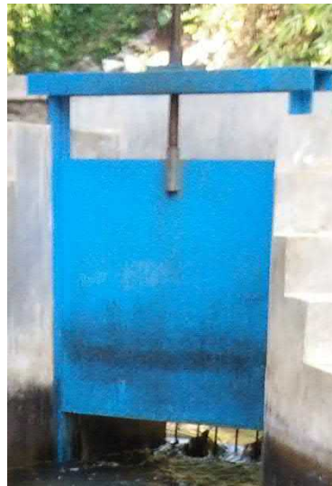
Gambar 2.2 Pintu Air (Intake) (Sumber: Dokumentasi PLTMH Sokokembang)
