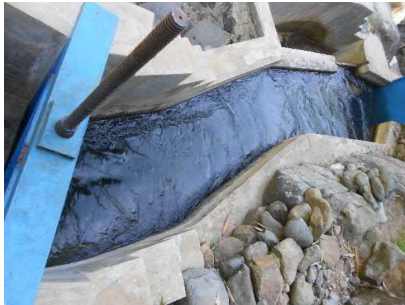
Gambar 2.3 Bak Pengendap / Bak Penenang (Sumber: Dokumentasi PLTMH Sokokembang)
