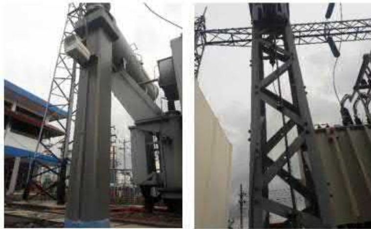
Gambar 3.2 Struktur penyangga Lightning Arrester Sumber : (Rizaldy, 2017)
