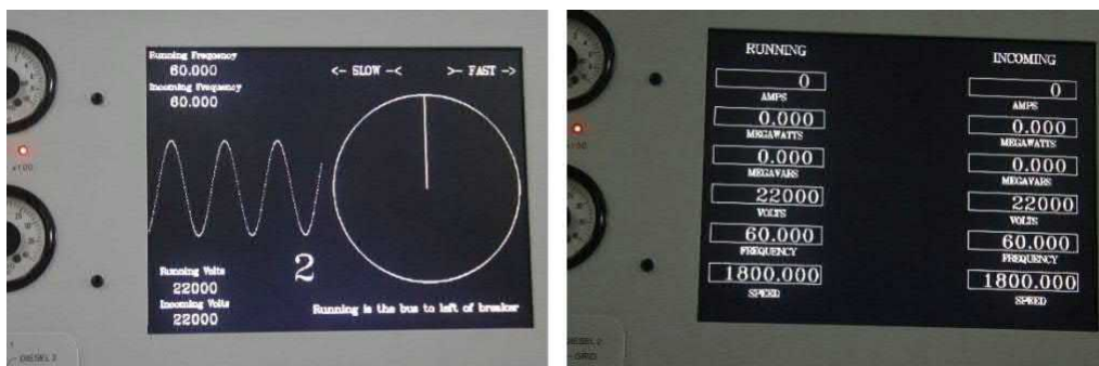
Gambar 2.9 Frekuensi Kerja Yang Sama (Hasil Proses Sinkronisasi Generator) (Sumber: DAC #490 Laboratorium Teknik Elektro, UNNES)
