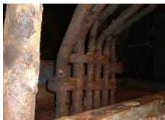
Gambar 2. 4 Korosi merata pada pipa ballast (Utomo, 2009)
