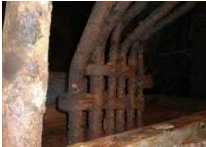
Gambar 2.1 Korosi merata pada pipa ballast (Utomo, 2009)
