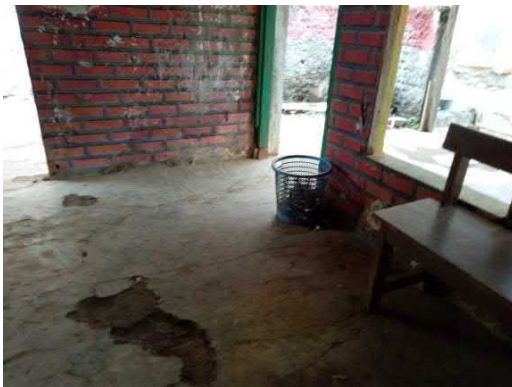
Gambar 9. Kondisi Lantai yang Berlubang di Salah Satu Kantin
