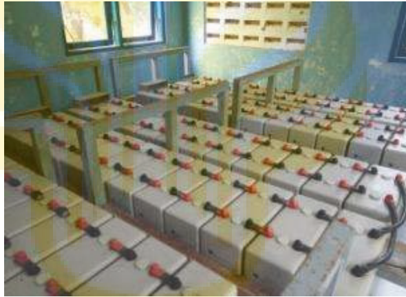
Gambar 2.2 Baterai/Accu pada PLTH Pantai Baru Bantul
