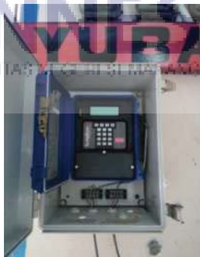
Gambar 2.6 Data Logger pada PLTH Pantai Baru Bantul
