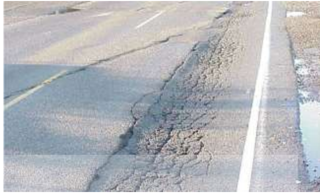
Gambar 2.1. Alur ( rutting ) pada badan jalan (Bakti, 2005)
