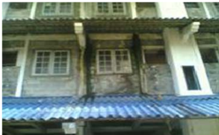
Gambar 3. Kondisi kerusakan di Rusunawa Pekunden (foto pribadi 23-11-2010)
