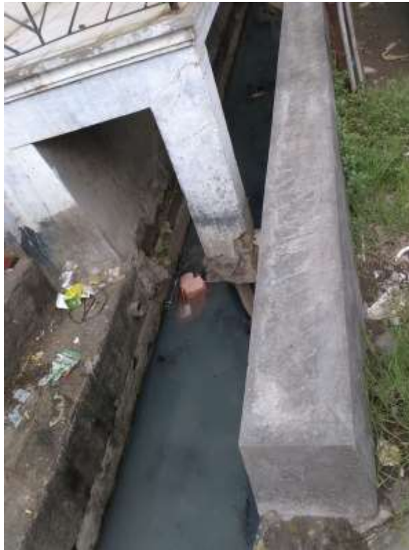
Saluran drainase yang tersumbat di Kelurahan Bandarharjo Wilayah Kerja Puskesmas Bandarharjo
