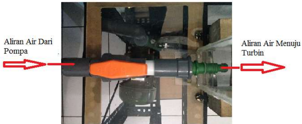
Gambar 4.4 Pipa pnghubung antara pompa air dengan turbin
