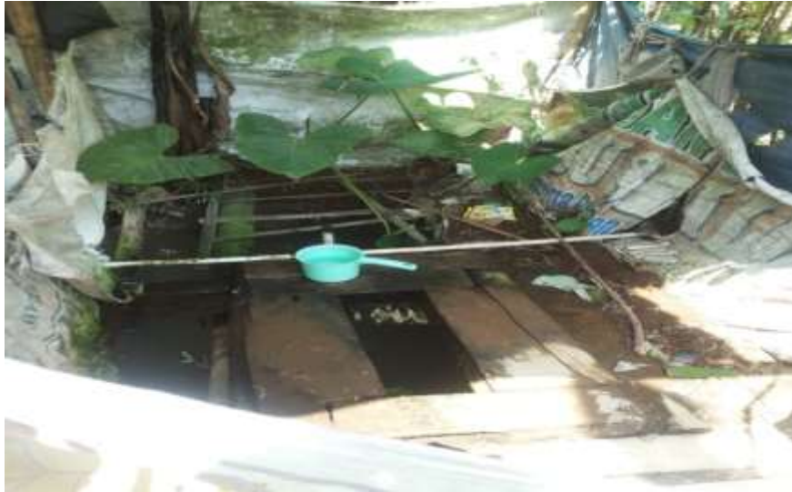
Jamban Pribadi Tidak Memenuhi Syarat
