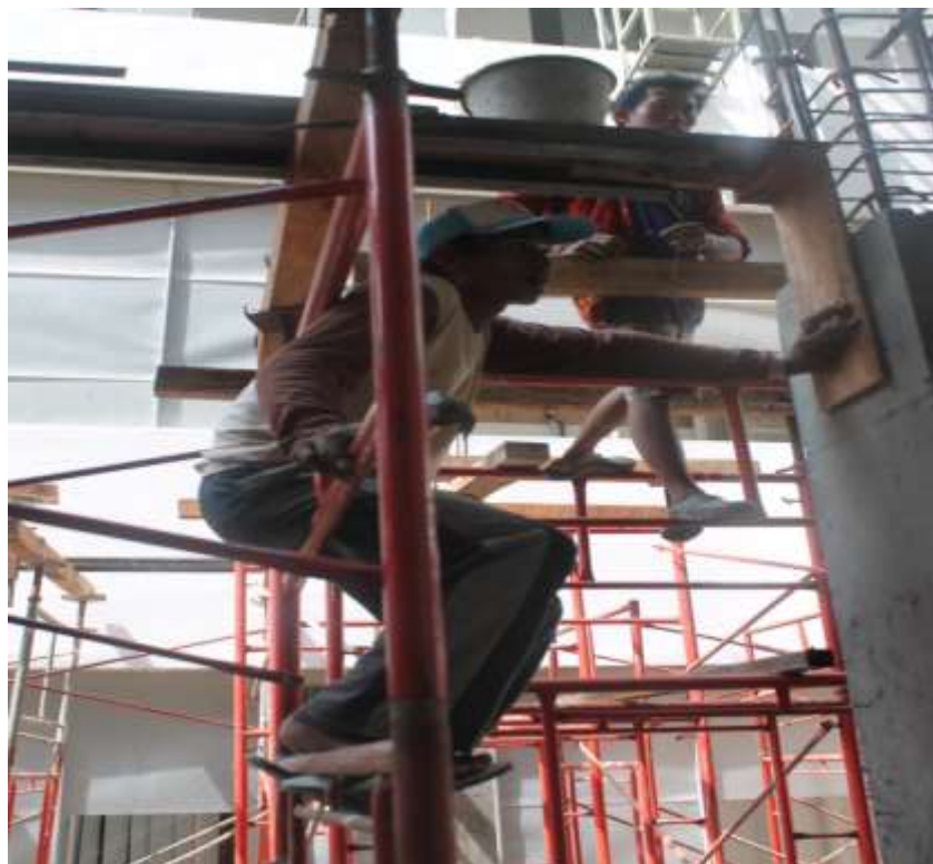
Gambar 4: Pekerja tidak menggunakan APD
