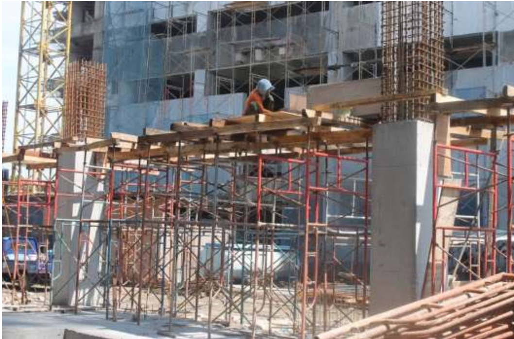
Gambar 3: Pekerja tidak menggunakan APD
