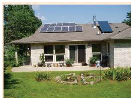
Panel surya dipasang di atap rumah untuk menangkap sinar
