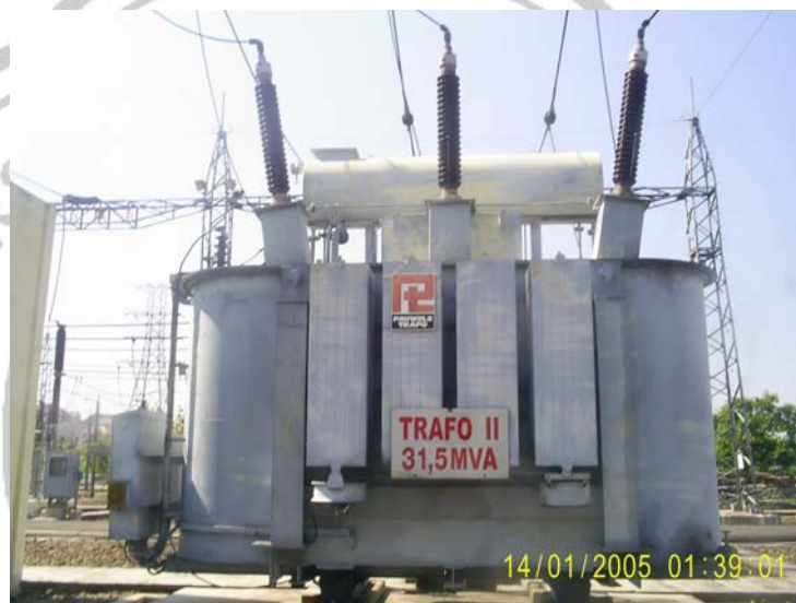
Gambar 3.2. Bentuk fisik trafo II tipe DRF 31.5/ 275
