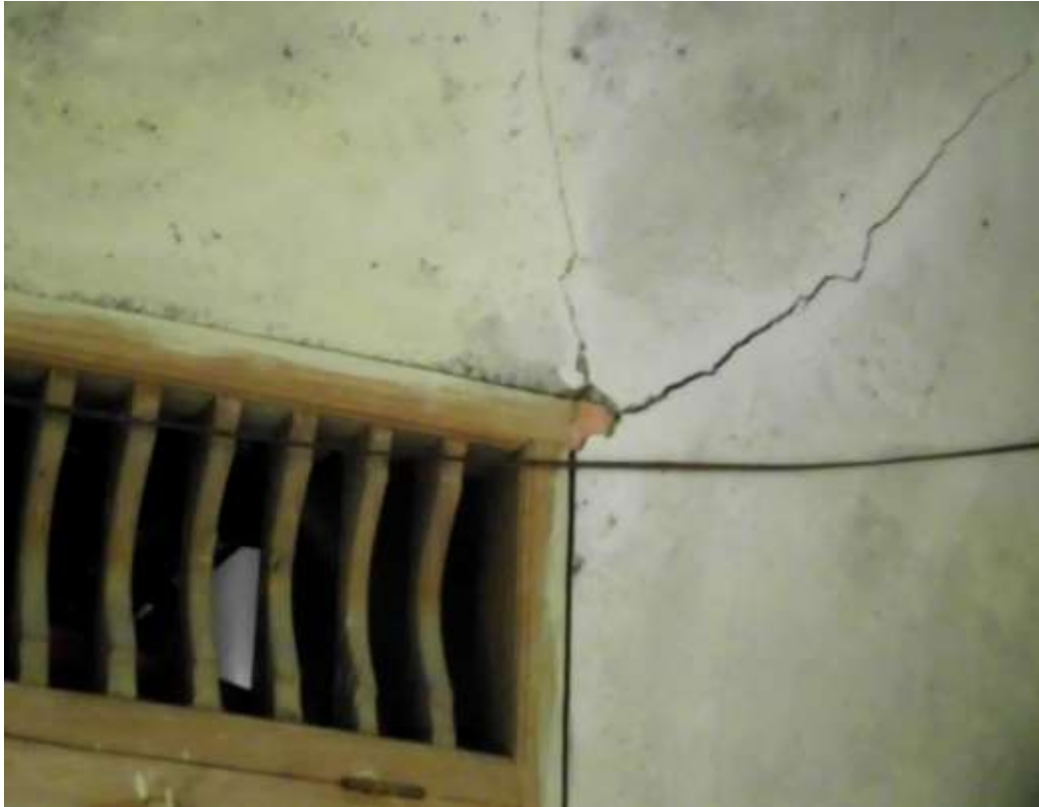
Gambar retaknya dinding dan lantai rumah warga
