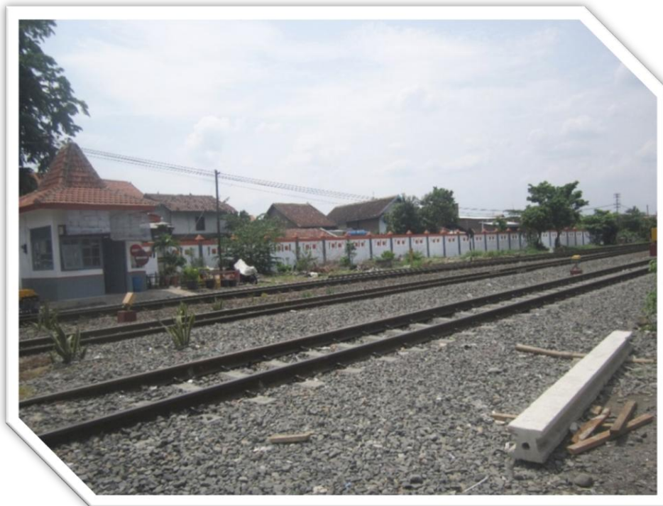
Kondisi saat ini pagar pembatas yang baru selesai dibuat di Kelurahan Pendrikanlor
