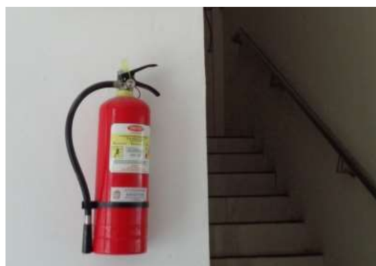
Dokumentasi tanggal 5 Maret 2015 Alat pemadam kebakaran di Perpustakaan
