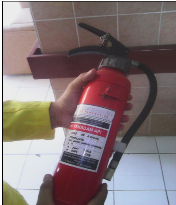
Keadaan tabung APAR yang masih bagus dan tidak berkarat
