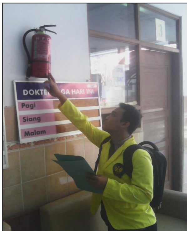
Pemasangan APAR dengan BOX dan APAR tanpa BOX
