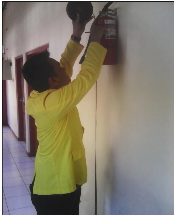
Pemasangan APAR dengan ketinggian yang lebih dari 1,2 meter
