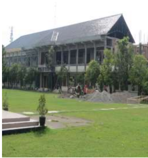
(Pembangunan Ruang Kelas Baru SMA Negeri 1 Sukoharjo dari Bantuan Dana Alokasi Khusus)
