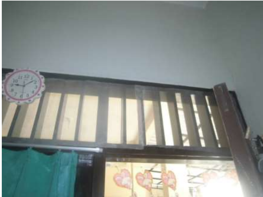
Kawat Kasa pada Lubang Ventilasi
