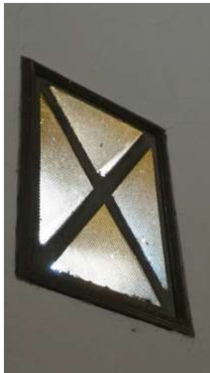
Gambar 4. Kondisi kawat kassa pada ventilasi
