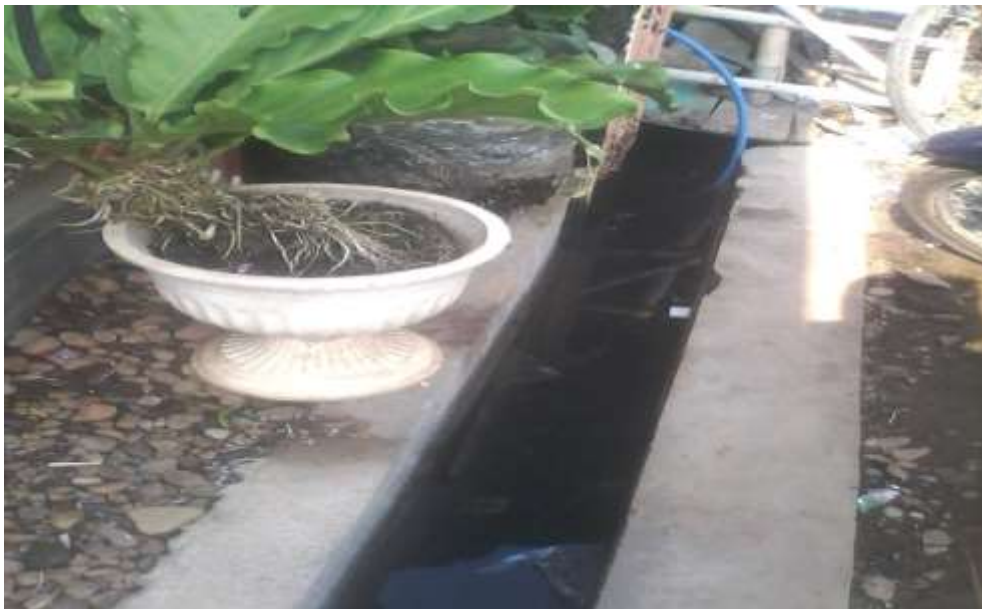
Gambar 9. Saluran pembuangan air limbah yang terbuka dan mengalir pelan
