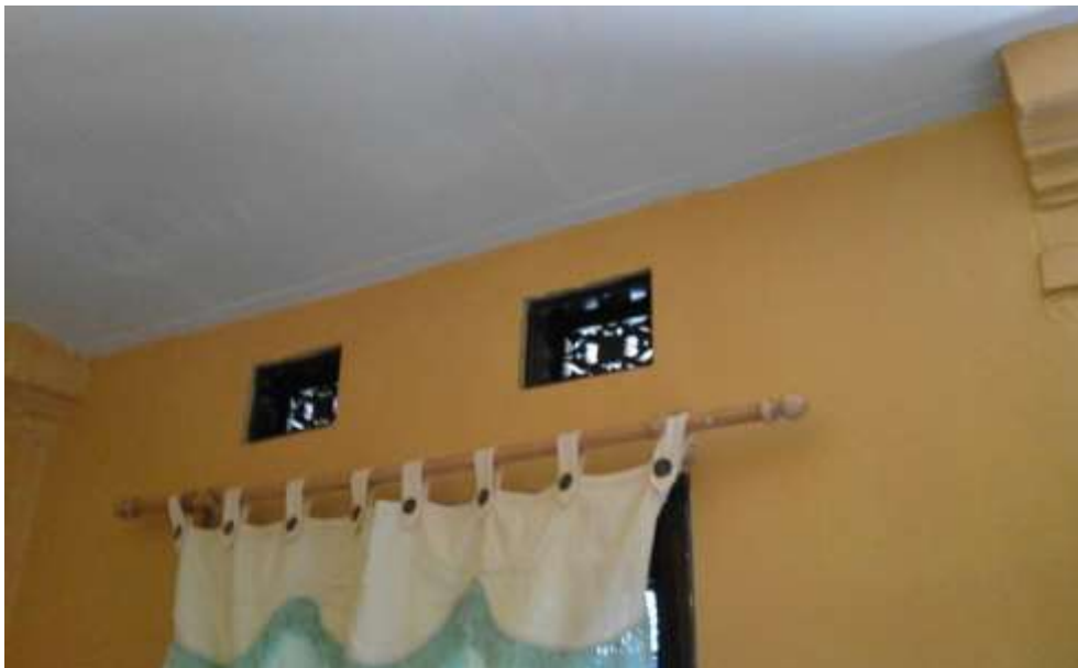
Gambar 13. Ventilasi udara yang tidak dilengkapi kasa
