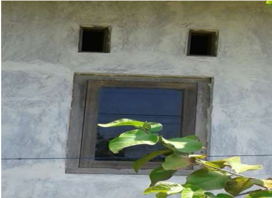
Gambar 4. Ventilasi udara yang tidak dilengkapi kawat kasa
