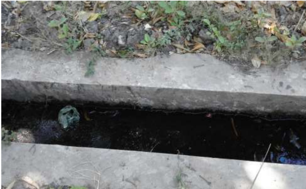
Gambar 14. Saluran pembuangan air limbah yang terbuka, kotor, dan menggenang
