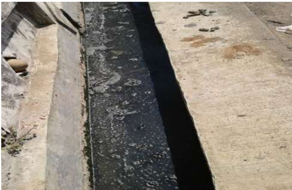
Gambar 3. Saluran Pembuangan air limbah yang menggenang
