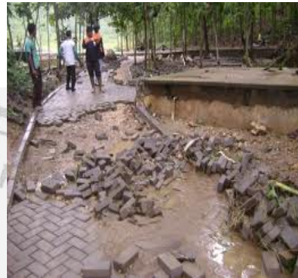
(Gbr. Kerusakan Jalan)
