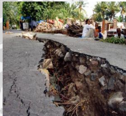
(Gbr. Jalan Rusak)
