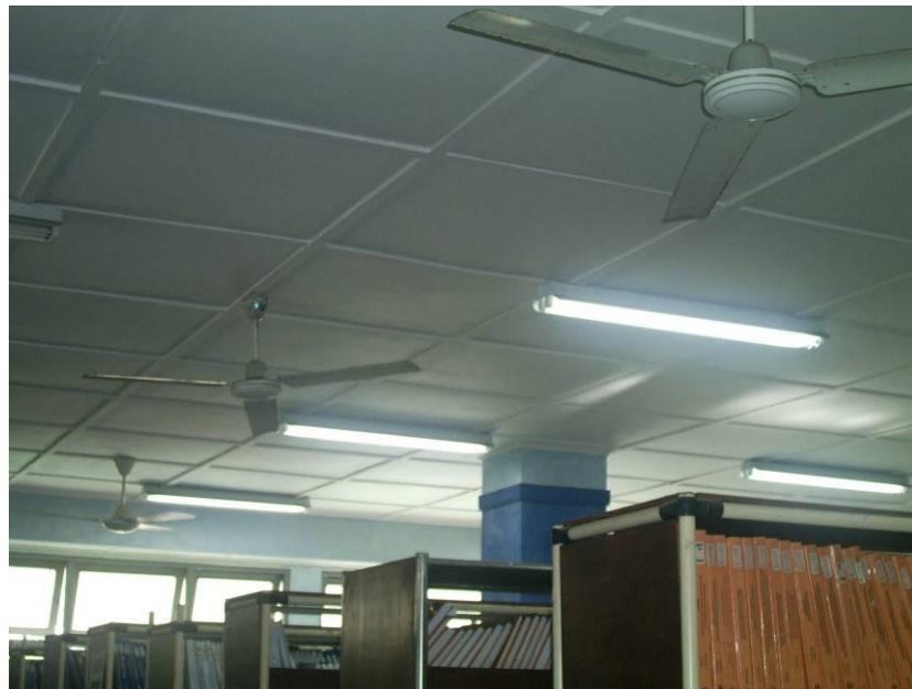
Gambar 5.13 Alat pengkondisi sirkulasi udara (Sumber: Dokumentasi peneliti, 2012)
