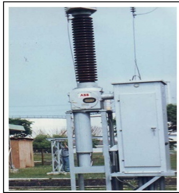
Gambar 2.6. Pemutus Tenaga (PMT) { Circuit Breaker (CB) }.
