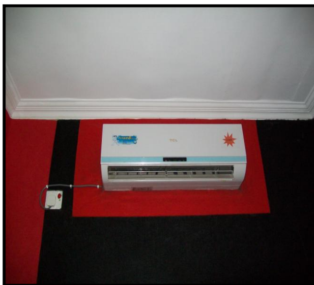
Gambar 4.16: Fasilitas AC atau Pendingin Ruangan (Foto: Yeyep, 05 Februari 2013)
