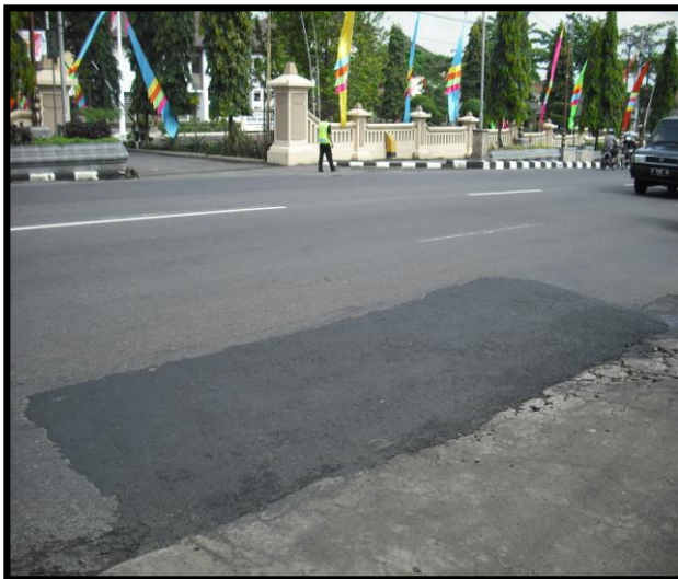
Gambar. Kerusakan Jalan
