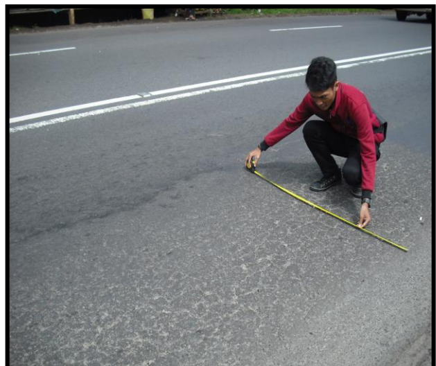
Gambar. Pengukuran Kerusakan Jalan
