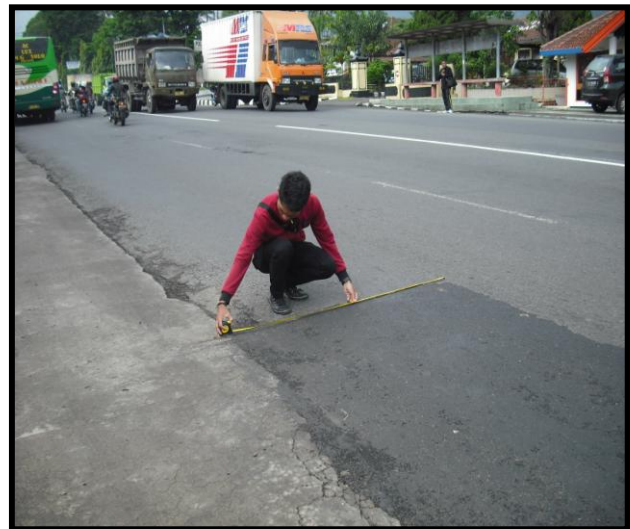
Gambar. Pengukuran Kerusakan Jalan
