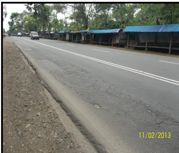
Gambar. Kerusakan Jalan
