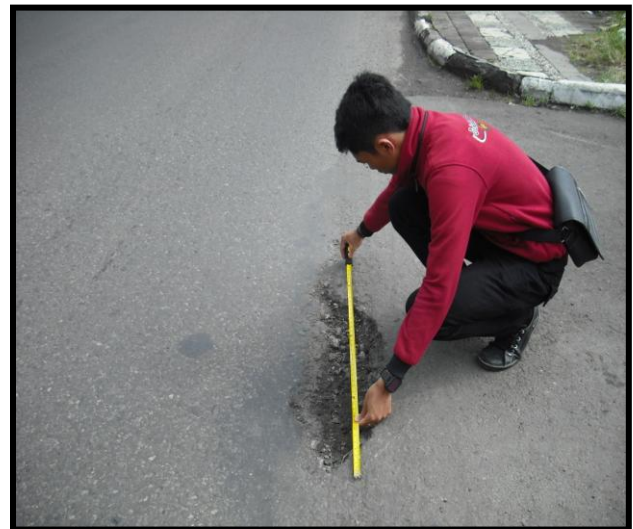
Gambar. Pengukuran Kerusakan Jalan
