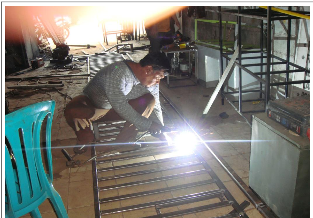
Pekerja las listrik yang tidak menggunakan alat pelindung wajah
