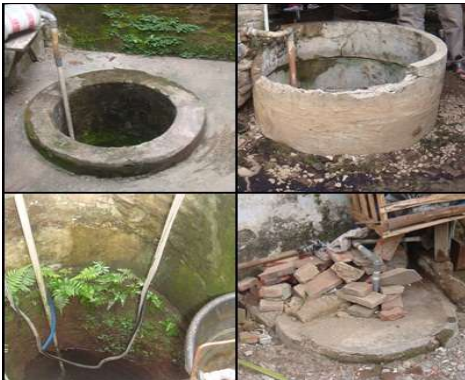
Kondisi Fisik Sumur Gali yang tidak memenuhi syarat
