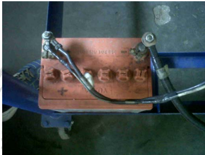
Gambar 3.2. Pemeriksaan Kondisi Baterai
