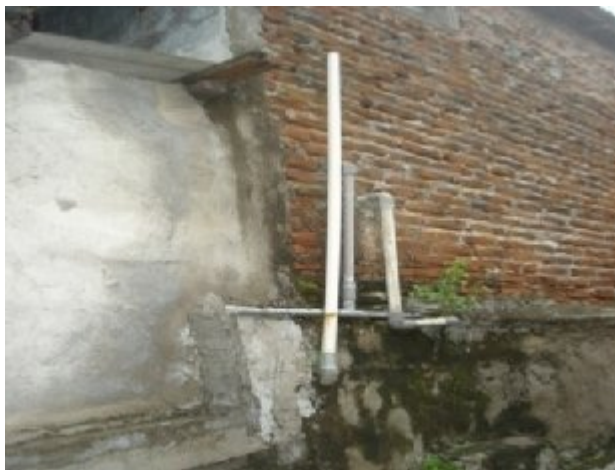
Gambar 11. Pipa untuk Menyalurkan Air dari Sumur ke Selang Warga (Dokumen Pribadi Galih tahun 2013)
