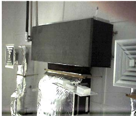
Gb. 3.4 Evaporator di dalam Fan Koil Unit
