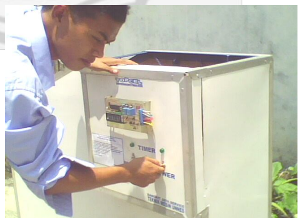
Menghidupkan Power pada Control Panel
