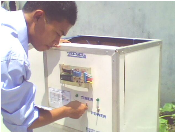
Menghidupkan Timer pada Control Panel
